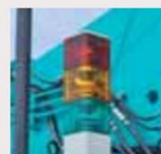
●過負荷外部表示灯
